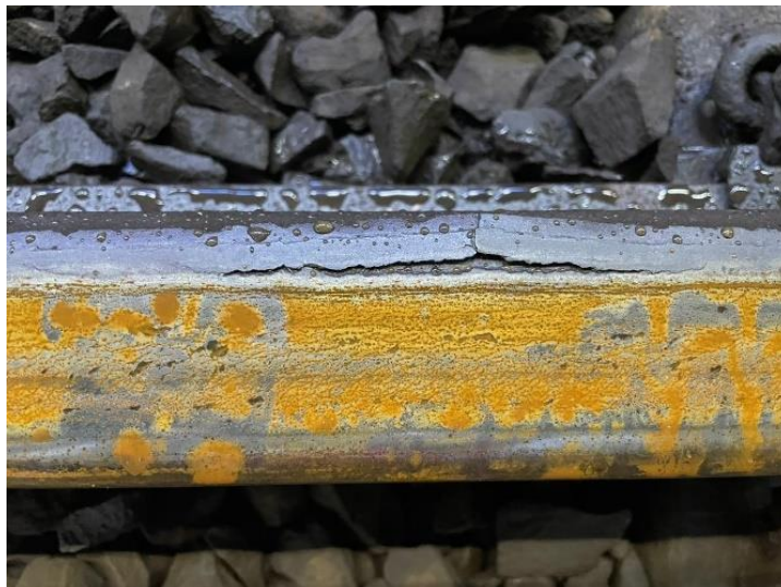
Gambar 15. Posisi retak RCF di jalur II Emplasemen Stasiun Kampungbandan
