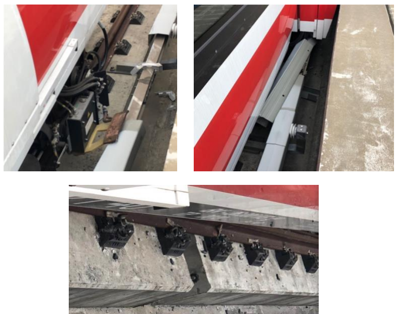
Gambar 2. Kerusakan prasarana akibat tabrakan
