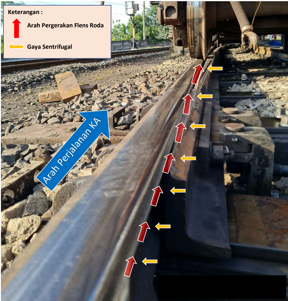
Gambar 16. Proses Terjadinya Anjlokkan Ex. KA 3077
