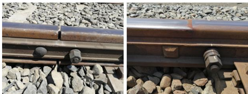
Gambar 12. Kondisi celah sambungan rel
