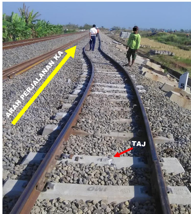
Gambar 18. Buckling pada rel di lokasi kejadian
