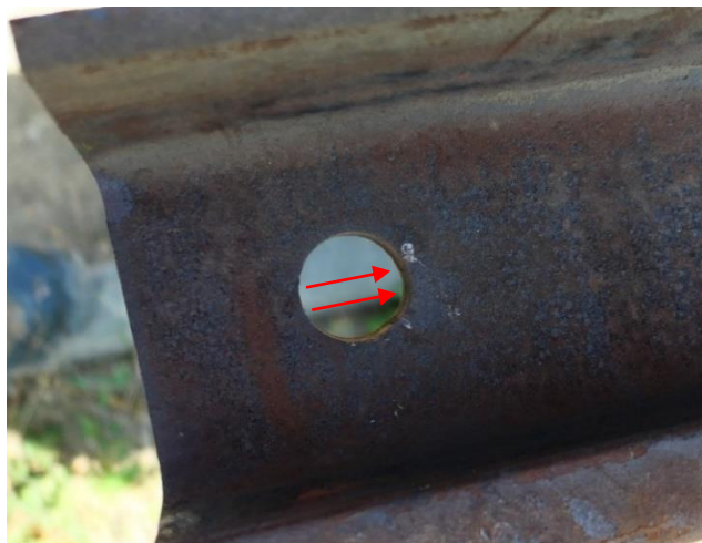
Gambar 7. Deformasi plastis pada permukaan lubang badan rel
