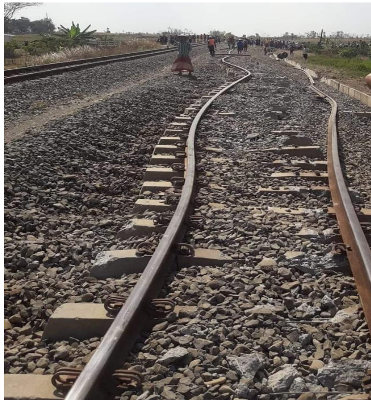
Gambar 15. Kondisi prasarana kejadian anjlok KA 2709, 24 September 2018
