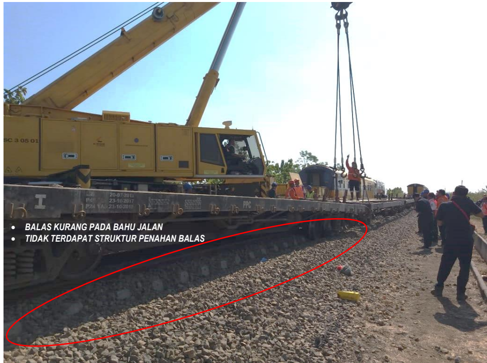
Gambar 13. Kondisi balas kurang pada bahu jalan serta tidak ditemukan adanya struktur penahan balas
