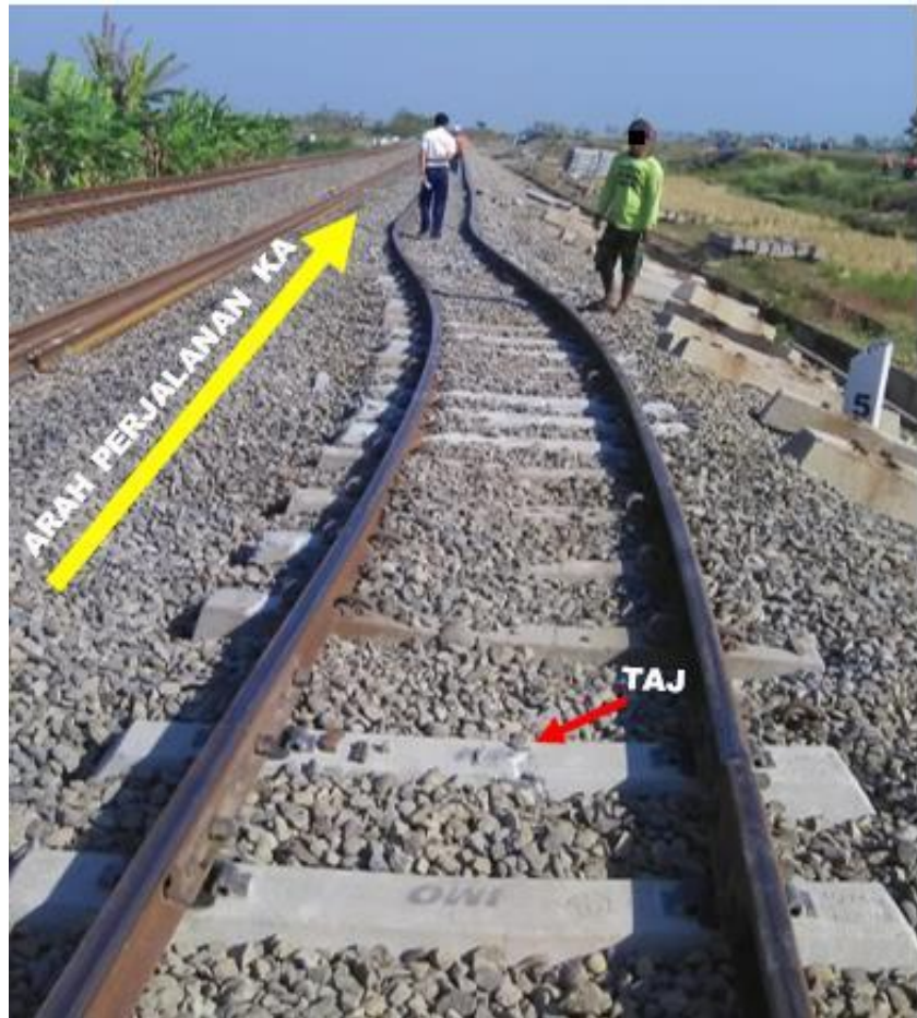
Gambar 4. Buckling pada rel di sekitar TAJ
