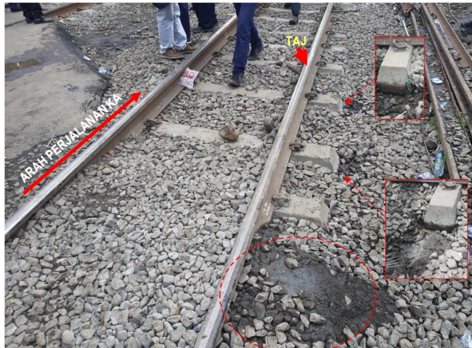
Gambar 9. Mud pumping di JPL 28 beberapa bantalan sebelum TAJ
