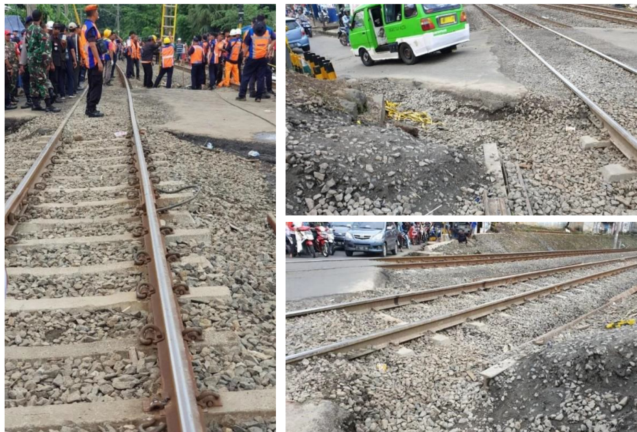
Gambar 8. Kondisi konstruksi perlintasan sebidang JPL 28 lokasi anjlokkan
