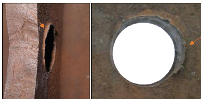
Gambar 5. Deformasi plastis pada lubang rail web
