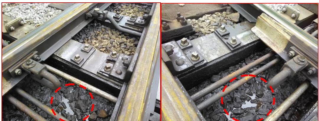
Gambar 9. Kecrotan ( mud pumping ) di wesel 39AB
