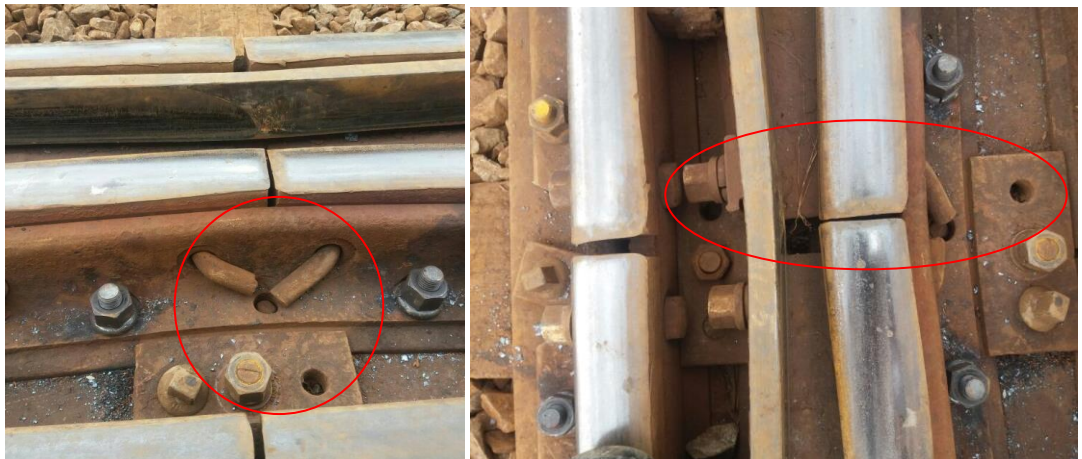
Gambar 7. Pemasangan baut wesel 39 AB yang tidak sesuai ukuran
