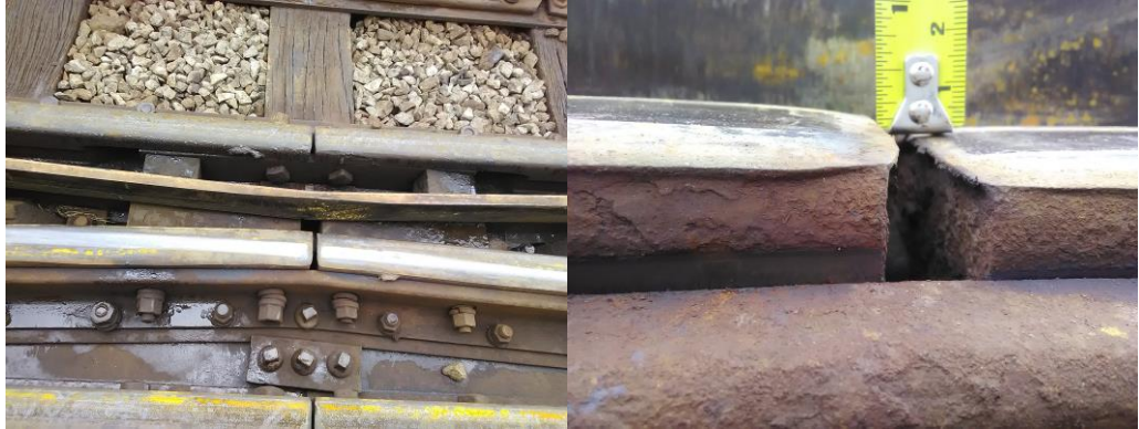
Gambar 3. Kondisi Wesel Inggris No. 39 ABCD Yang Aus
