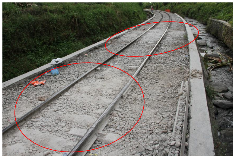
Gambar 7. Ballast mati dengan kondisi penuh tumpahan semen
