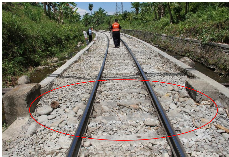
Gambar 9. Batu dengan ukuran yang tidak sesuai difungsikan sebagai ballast
