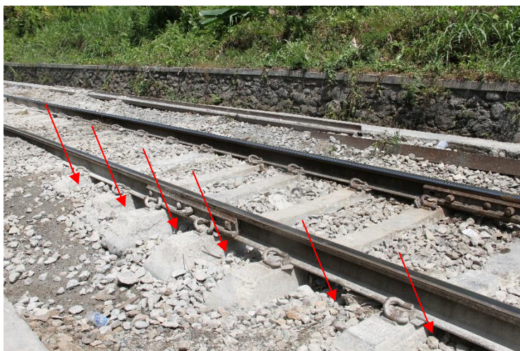
Gambar 10. Kondisi ballast kurang dilokasi kejadian
