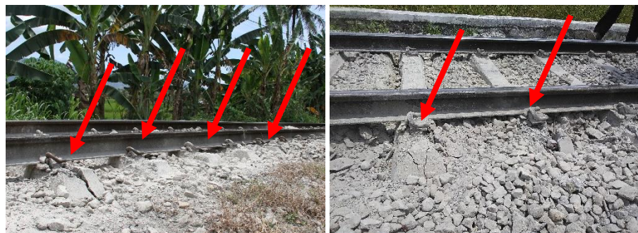
Gambar 4. Bantalan beton pecah akibat anjlokan
