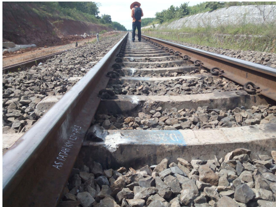
Gambar 5. Bantalan yang cacat akibat benturan patahan as roda GB 50 11 283 di Km 121 + 343
