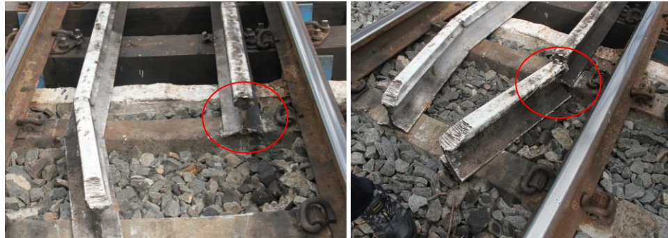
Gambar 3. Patahnya Guard Rail akibat benturan dari As roda
