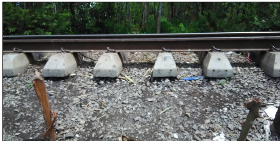
Gambar 6. Kondisi ballast tipis di Km. 238 + 860
