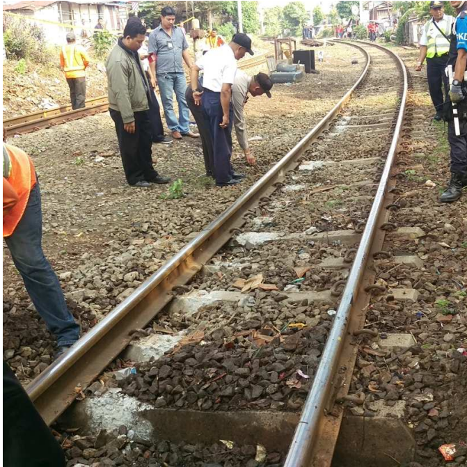
Gambar 5. Bantalan beton yang pecah
