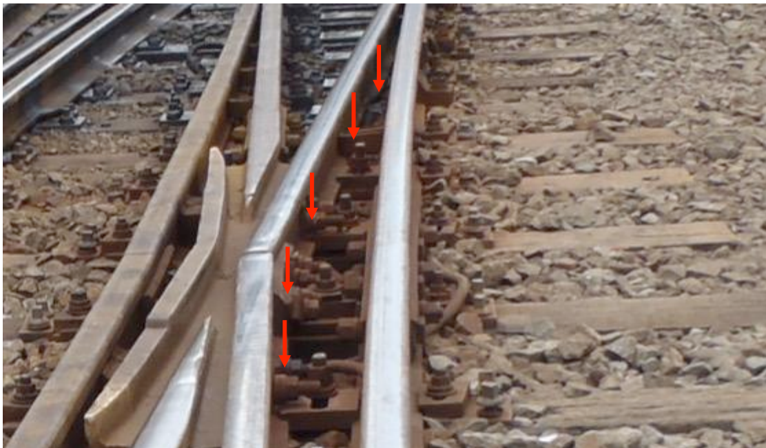
Gambar 11. Jejak goresan flens roda pada baut rel lidah wesel dan rel lantak wesel 11A3 serta wesel 11A4
