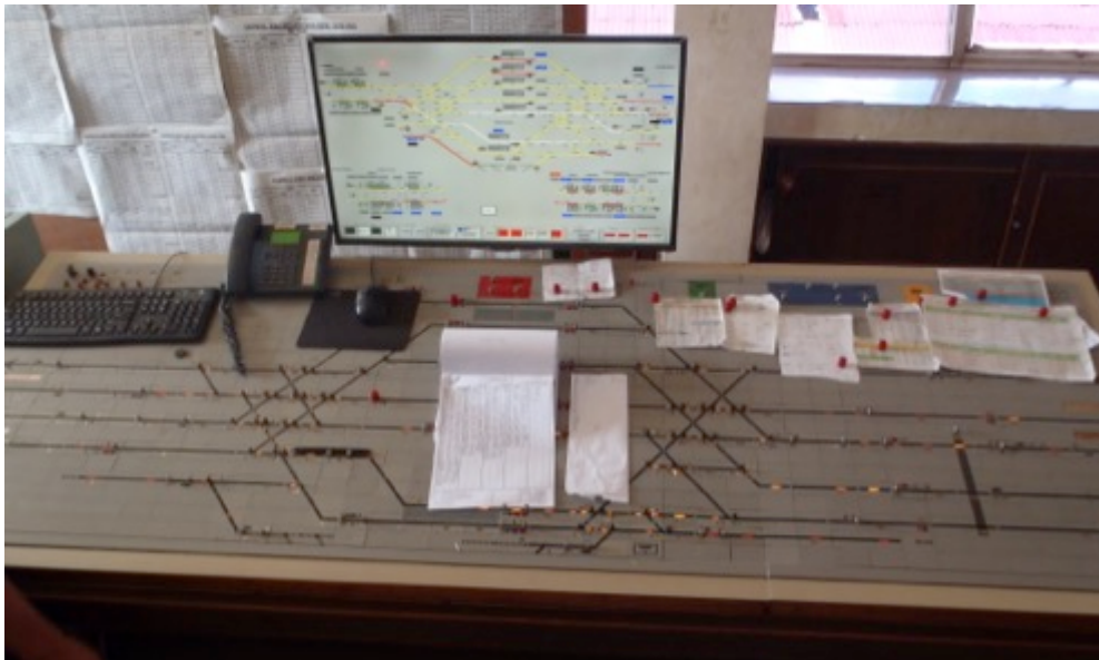
Gambar 17. Meja pelayanan/LCP Stasiun Manggarai
