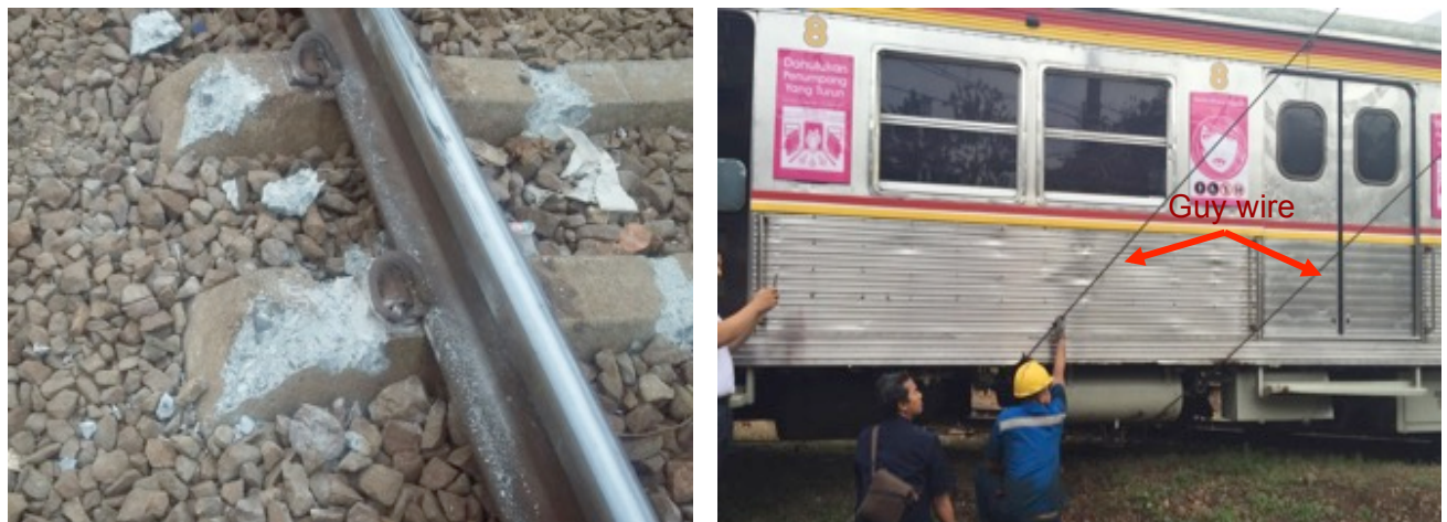
Gambar 4. Bantalan beton yang rusak dan tembereng/ guy wire - penahan tiang beton LAA yang terkena badan kereta
