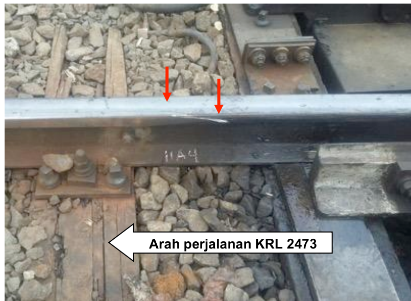
Gambar 12. Goresan flens roda naik ke kepala rel lantak di ujung lidah wesel 11A4 sebelah kanan
