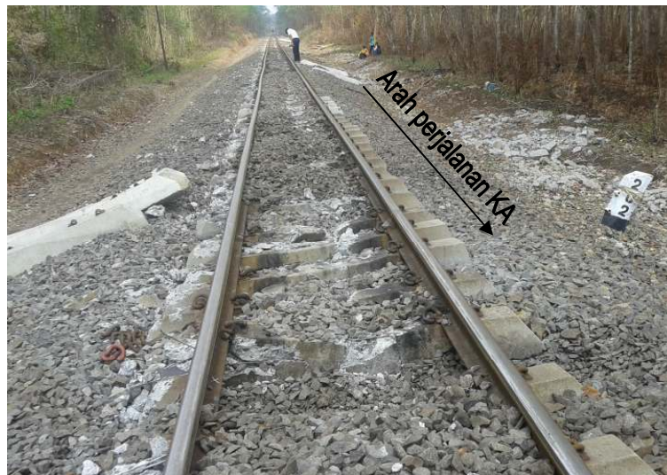
Gambar 3. Kerusakan komponen jalan rel di lokasi anjlokan
