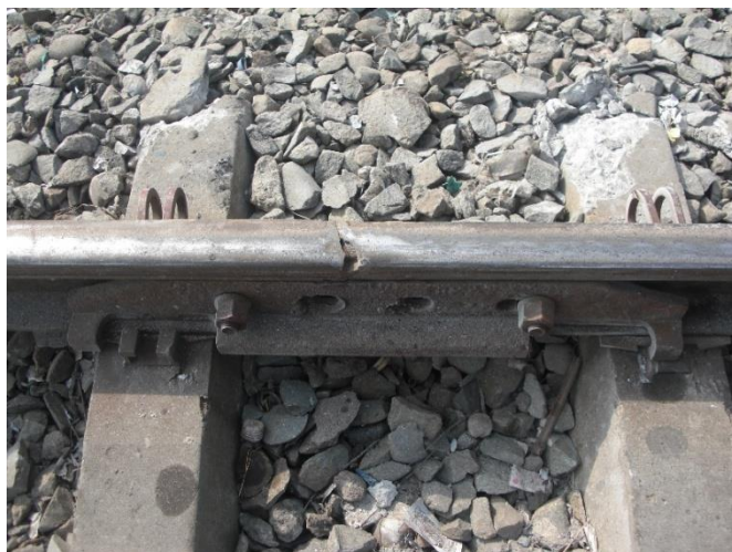
Gambar 4. Kondisi sambungan rel yang patah disambung dengan pelat sambung di lokasi kejadian
