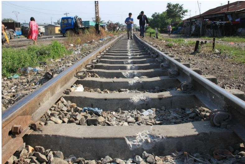
Gambar 7. Kondisi jalan rel dengan balas kurang di lokasi kejadian
