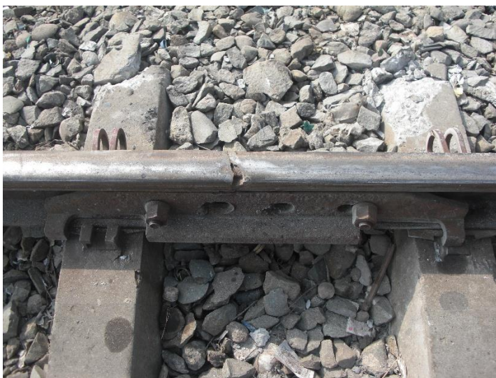
Gambar 6. Kondisi sambungan rel yang patah disambung dengan pelat sambung di lokasi kejadian
