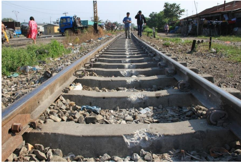
Gambar 5. Kondisi jalan rel dengan balas kurang di lokasi kejadian
