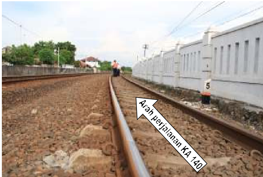
Gambar 4. Pemasangan semboyan 2A di Km 87+200 tidak terlihat dari Km 87+500
