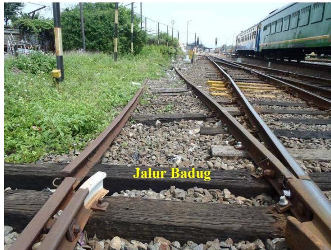
Gambar 7. Jalur badug yang sudah rusak dan tidak dirawat
