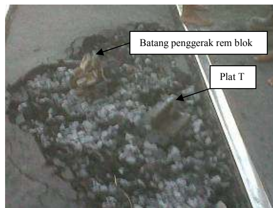
Gambar 5. Batang penggerak rem blok dan Plat T ditemukan di tengah aspal jalan perlintasan JPL 324 (foto rekonstruksi)
