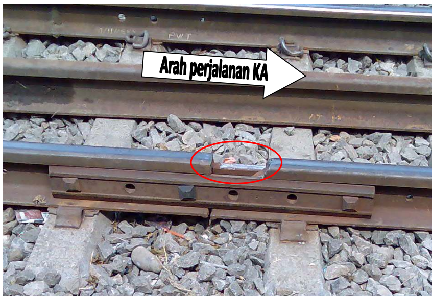
Gambar 9. Rel gompal pada sambungan rel di Km 47+650
