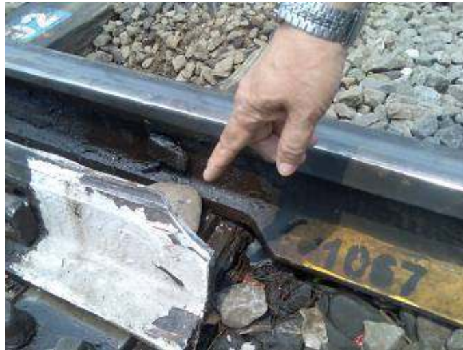
Gambar 3. Ujung lidah wesel 23 yang rusak akibat PLH
