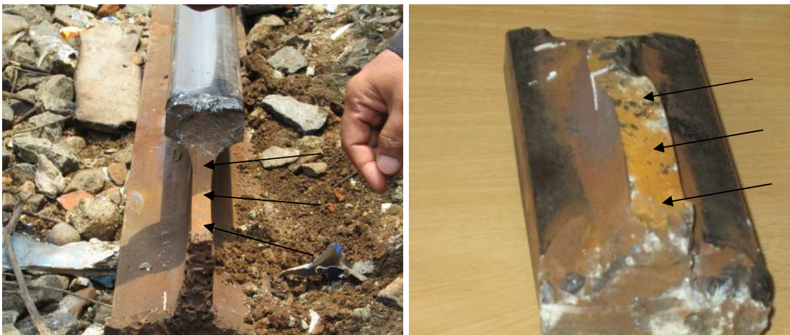
Gambar 11. Permukaan rel gompal yang sudah berkarat
