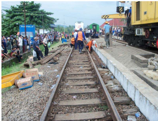
Gambar 3. Kondisi jalan rel di jalur III emplasemen St. Langen, Banjar, Jawa Barat
