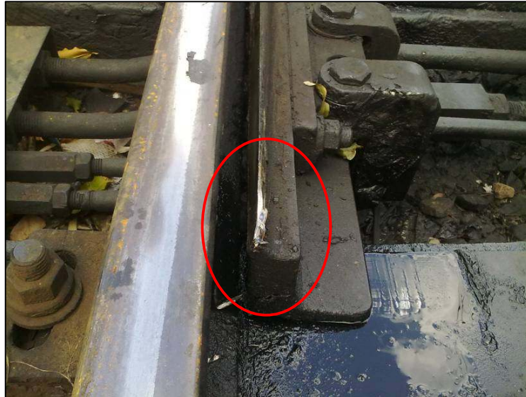
Gambar 2. Lidah Wesel 11A4 yang tertabrak di St. Manggarai
