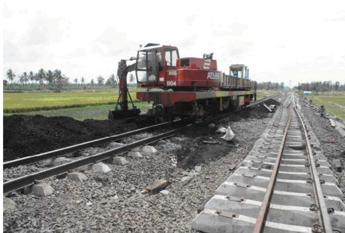
Gambar 4. Kondisi Jalur I dan Jalur II akibat PLH.
