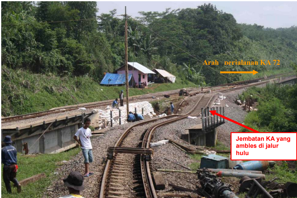
Gambar 3. Amblesan di Km 112+300/400 dan menyebabkan jembatan miring sehingga jalur hulu tidak bisa dilewati KA
