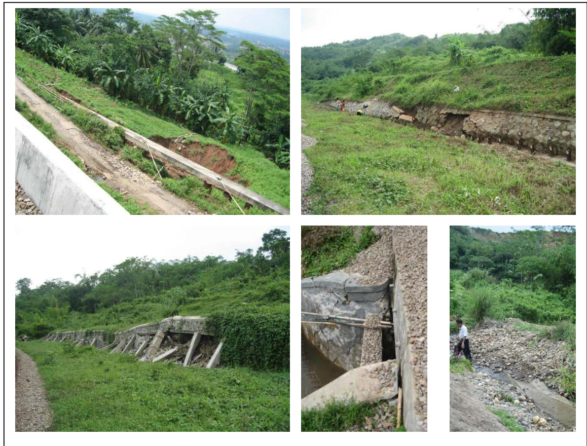
Gambar 13. Beberapa kondisi amblesan/longsor di wilayah Daop II Bandung PT Kereta Api Indonesia (Persero)
