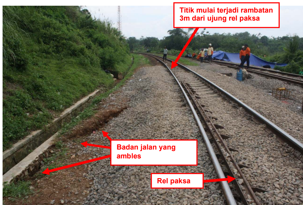
Gambar 12. Amblesan di Km 111+100/200 dan tanda bekas rambatan
