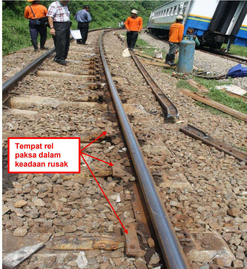
Gambar 4. Rel paksa, bantalan dan penambat jalan rel yang rusak
