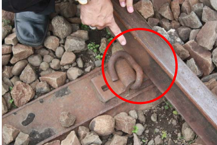
Gambar 6 . Penambat tidak mengikat rel
