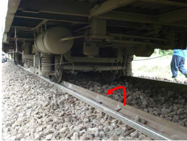
Gambar 5 . Alat penambat tidak ada dan/atau tidak berfungsi dan rel rebah
