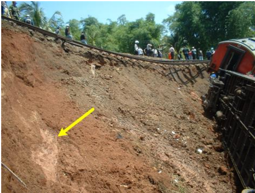
Gambar 2 . Kondisi lereng di lokasi PLH yang kenyang air
