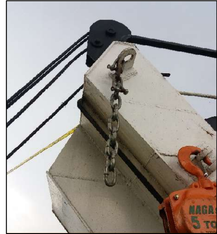
Gambar 6: Rantai dan shackle yang terpasang di pintu rampa buritan
