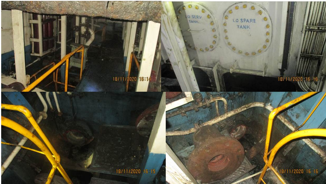
Gambar I-45: Kondisi di ruang tangki LO
