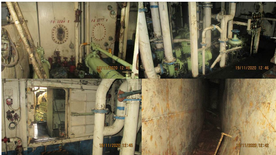
Gambar I-47: Kondisi ruang tangki bahan bakar
