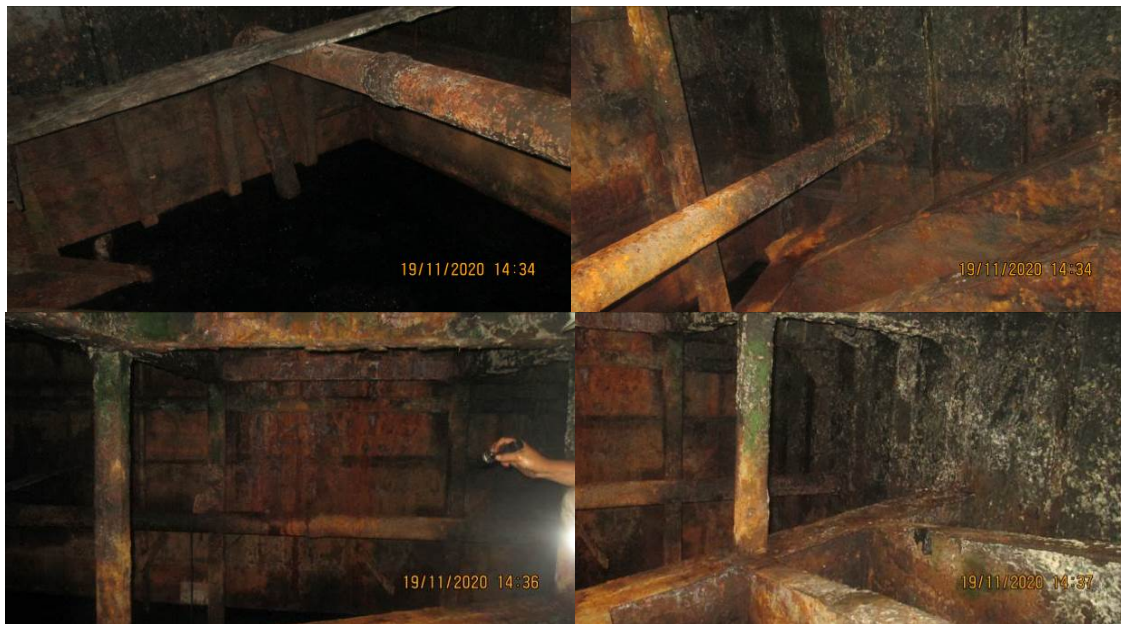
Gambar I-43: Kondisi tangki nomor 2 SWBT sebelah kanan
