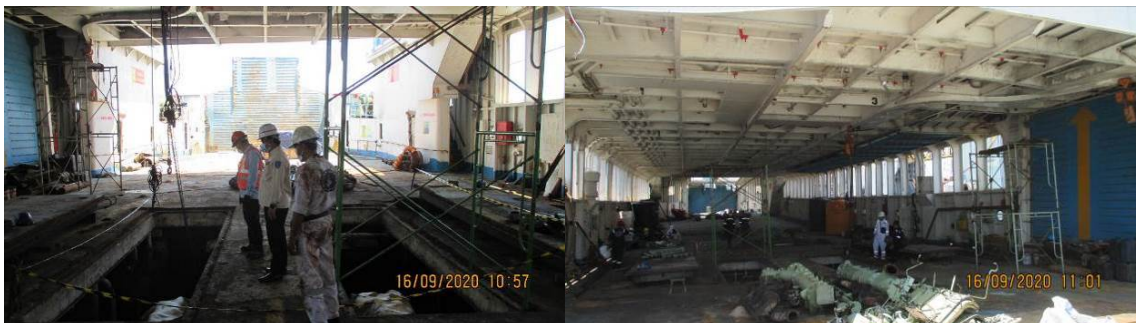
Gambar I-32: Pelat di geladak kendaraan buat akses ke kamar mesin dalam keadaan terbuka
