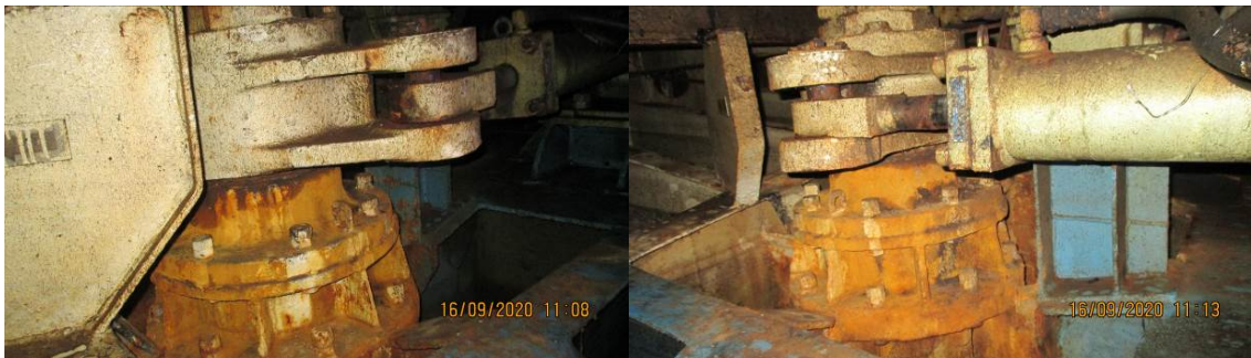
Gambar I-33: Kondisi pondasi dan tiller kemudi sebelah kanan
