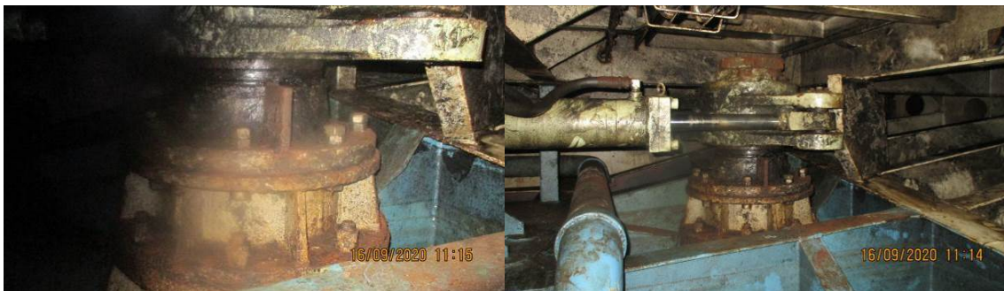
Gambar I-34: Kondisi pondasi dan tiller kemudi sebelah kiri
