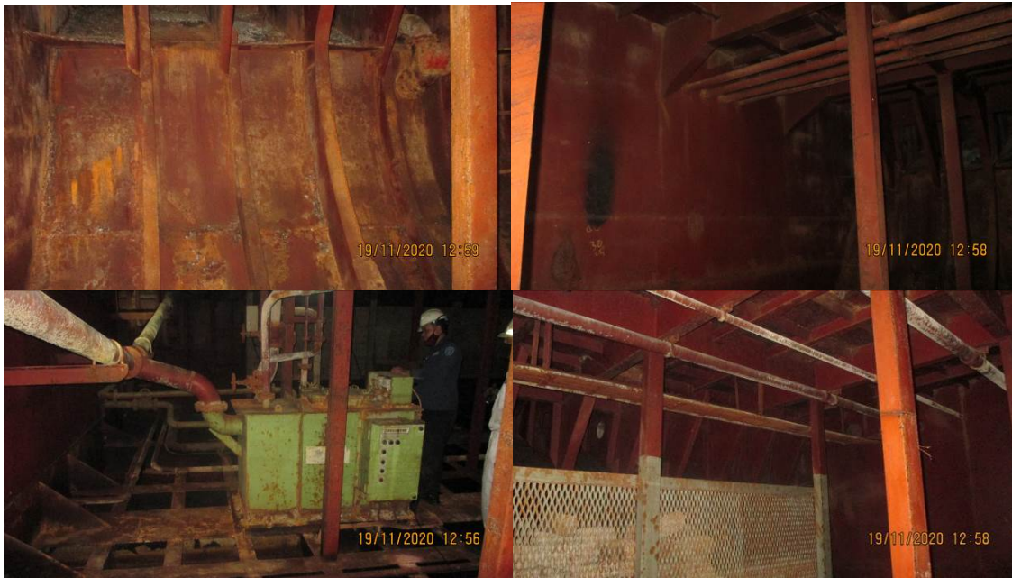
Gambar I-41: Kondisi ruang void (frame 66 -86)
