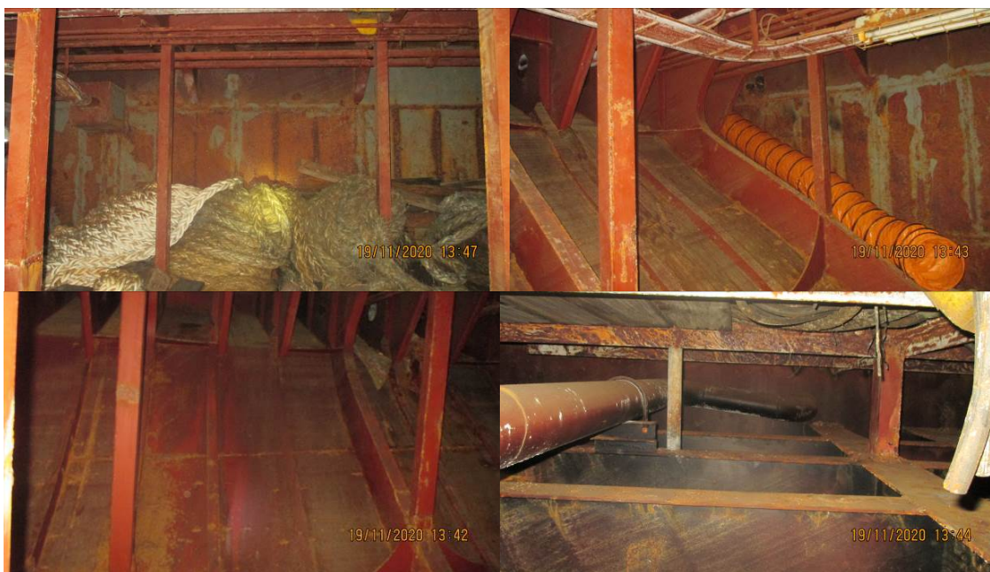
Gambar I-40: Kondisi ruang void (frame 86 -100)
