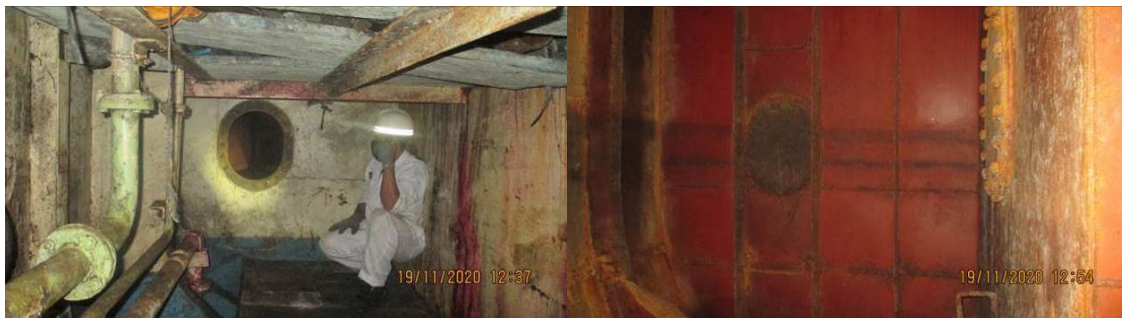
Gambar I-42: Manhole pada sekat melintang di frame 66 (kiri). Manhole sebelah kanan telah ditutup permanen.
