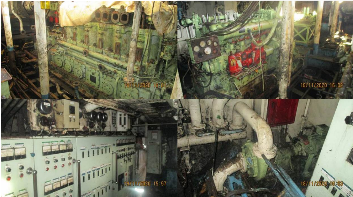
Gambar I-46: Kondisi kamar mesin
