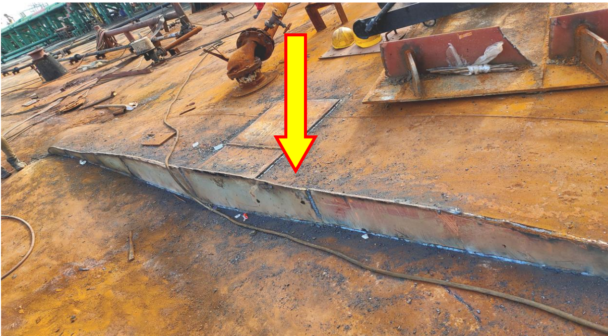
Gambar II-1: Geladak utama daerah Slop Tank yang pecah
