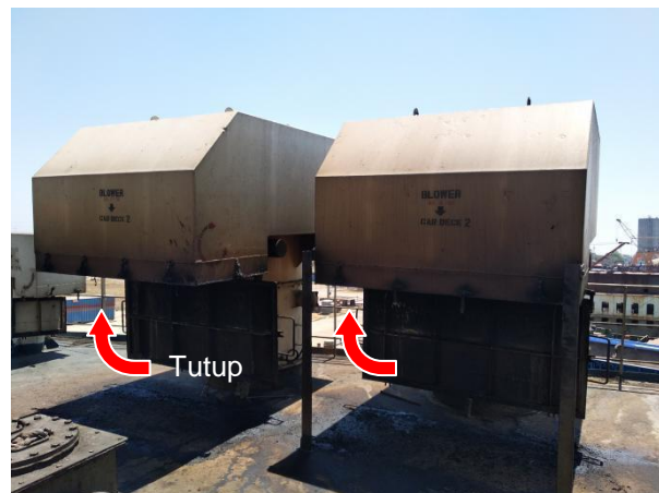
Gambar I-17: Blower Geladak Kendaraan dan Tutupnya Yang Terbuka
