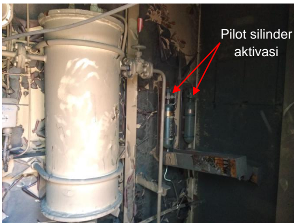
Gambar I-16: Pilot Silinder Aktivasi Sistem CO 2 Geladak Kendaraan di Stasiun Pemadam
