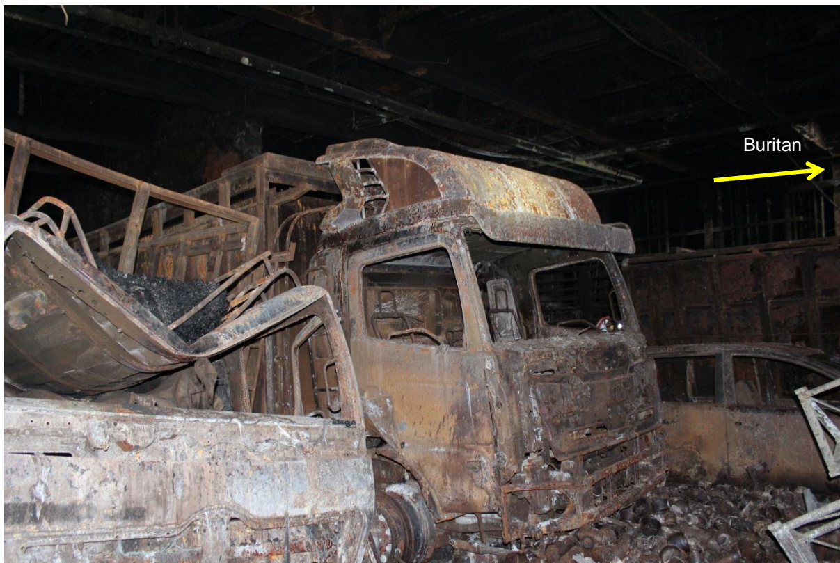
Gambar I-6: Kondisi Kendaraan di Geladak Kendaraan Atas
