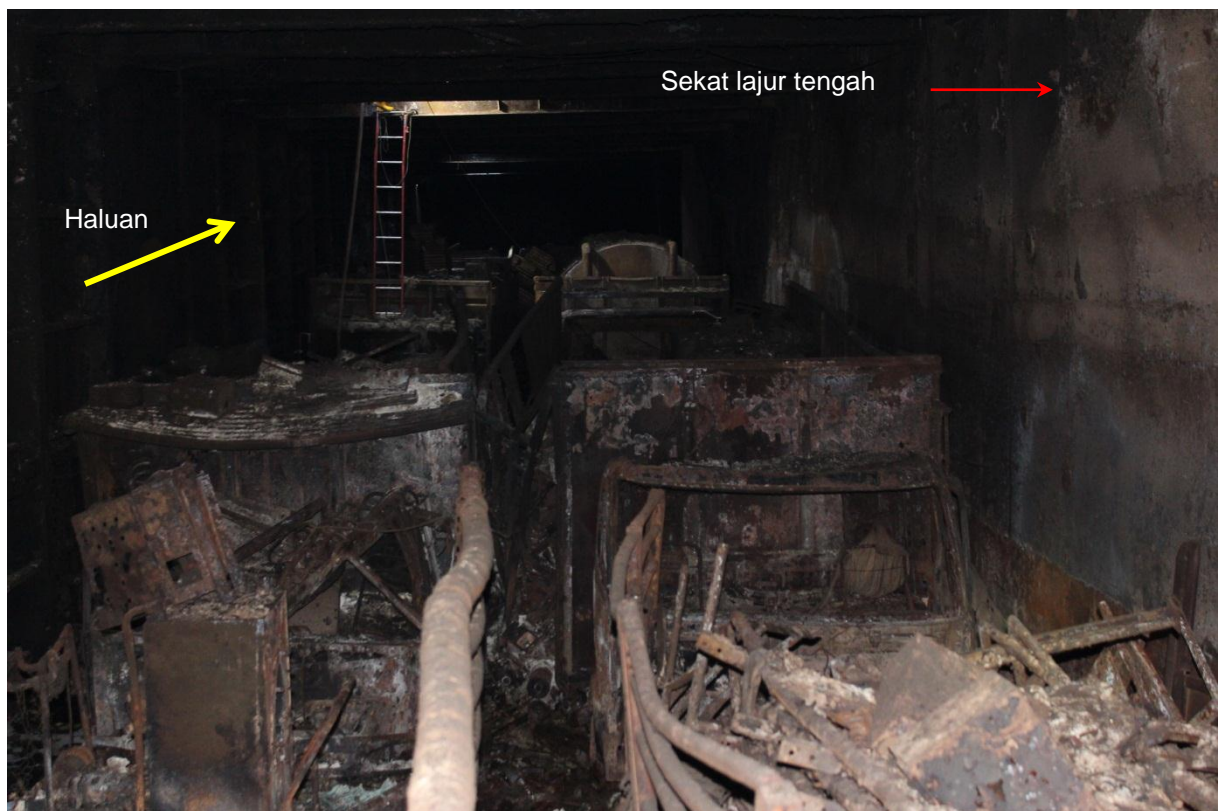
Gambar I-5: Kondisi Kendaraan di Dua Lajur Kiri
