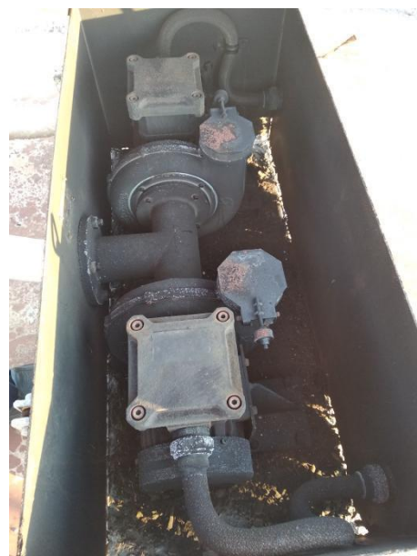
Gambar I-13: Exhaust Fan SESD
