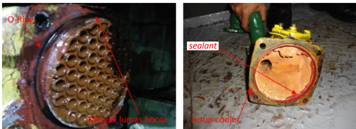
Gambar II-1: LO Cooler Bocor .
