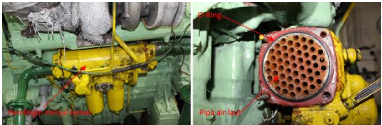
Gambar I-3: LO Cooler Mesin Bantu No. 3.
