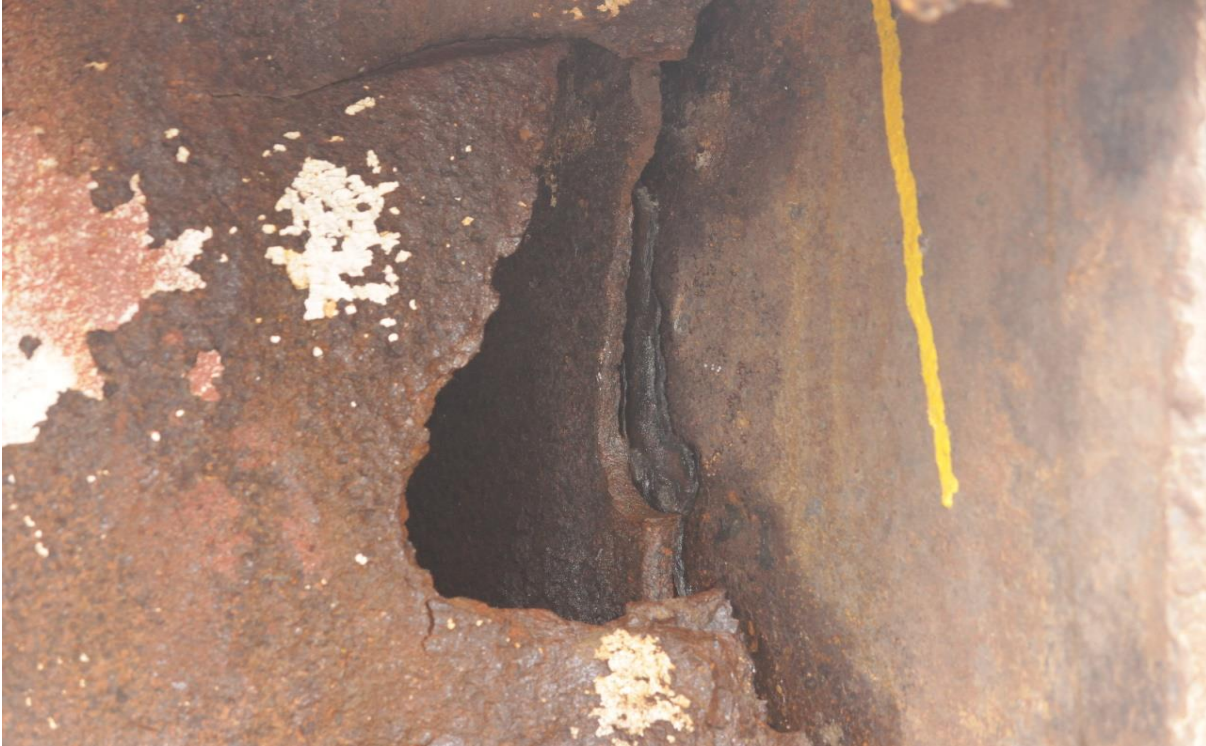
Gambar I-8: Korosi pada material konstruksi pintu rampa buritan bagian engsel No. 4
