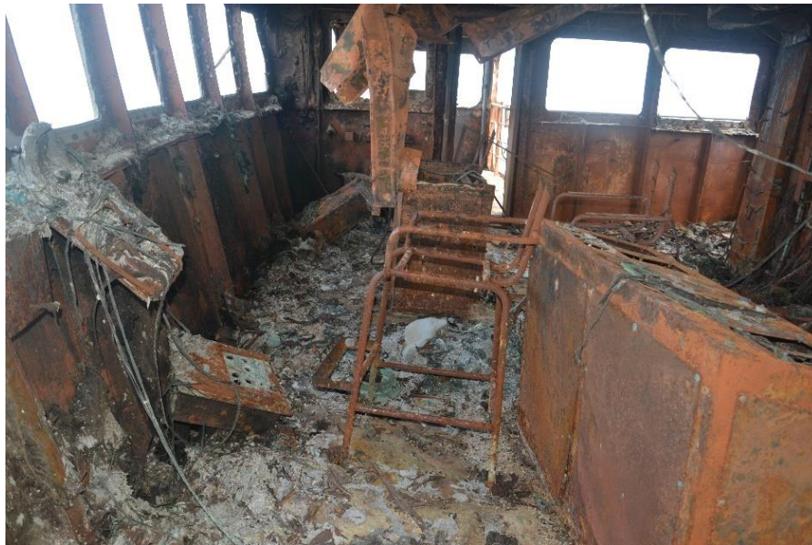
Gambar I-4: Kondisi anjungan kapal setelah kebakaran
