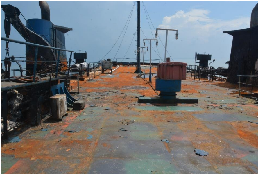
Gambar I-6: Kondisi geladak cuaca belakang mengalami perubahan bentuk
