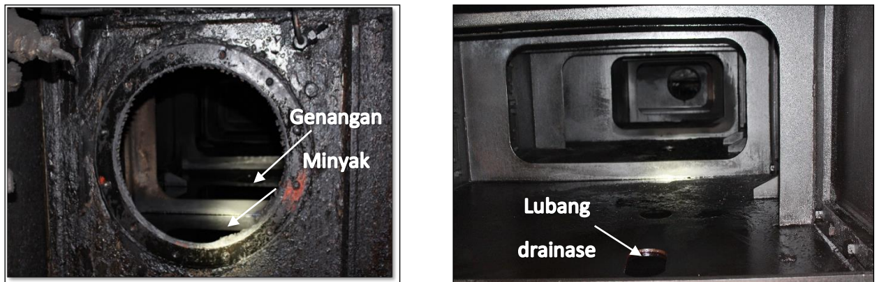
Gambar I-11: gambar genangan minyak dan lubang buangan (drainase) di ruang udara bilas mesin induk
