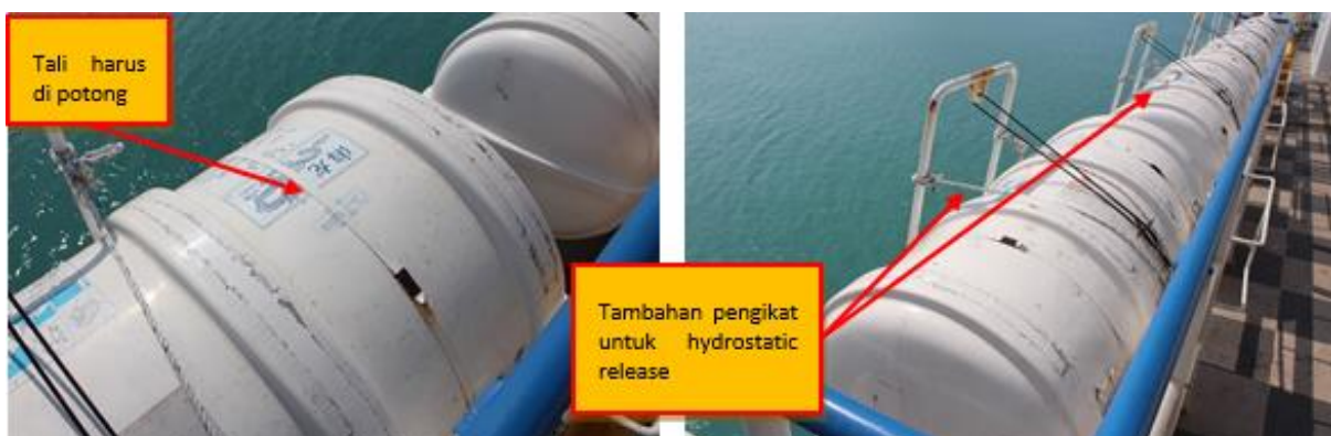
Gambar I-3: Pemasangan alat keselamatan tidak sesuai standar penggunaan.
