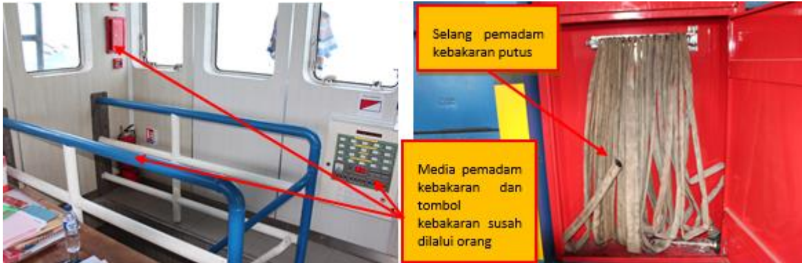
Gambar I-4: Penempatan alat pemadam kebakaran tidak sesuai.
