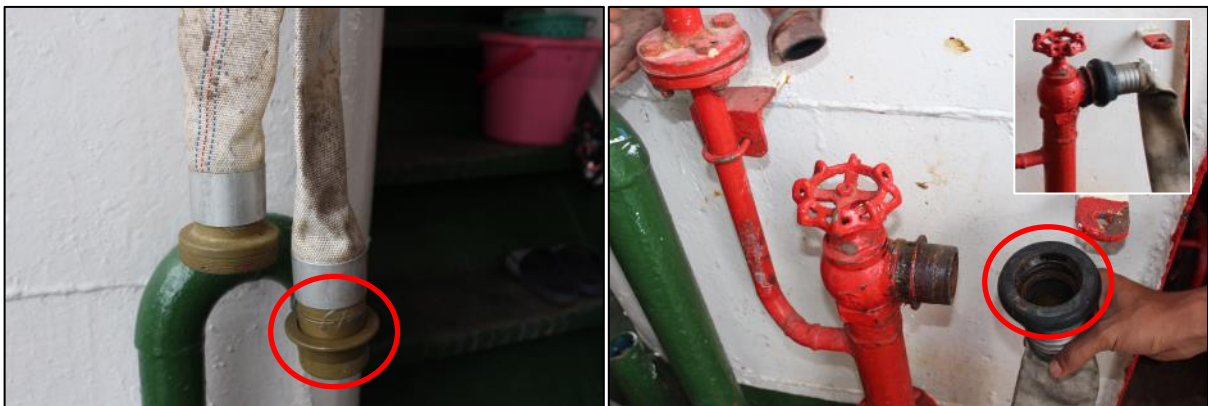
Gambar I-9 Kiri Satu Kopling Slang yang Berbeda Dengan Kopling Hidran di Geladak Kendaraan;
