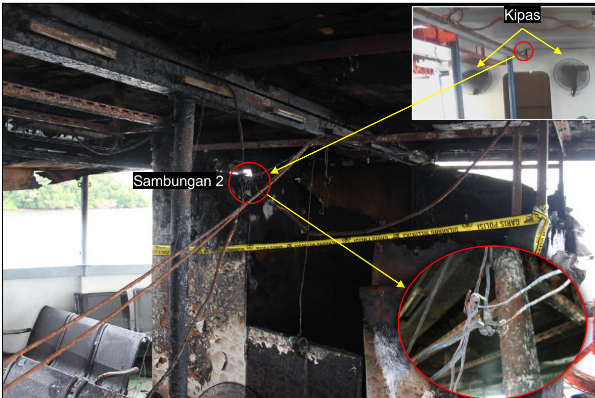
Gambar I-10 Kondisi Sambungan 2 Dengan Model Sambungan Tak Beraturan (Inzet: Dua Unit Kipas di Dinding Musala dan Sambungan 2)
