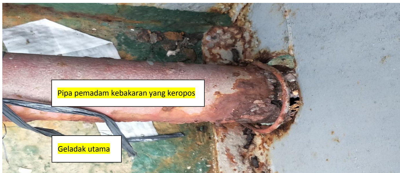
Gambar 9: Pipa pemadam kebakaran sudah keropos
