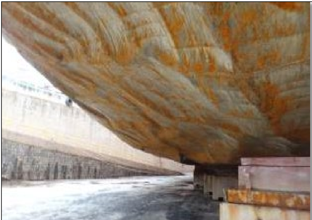
Gambar I-5: Kerusakan konstruksi Pelat dasar Tangki FPCentaurus Dream
