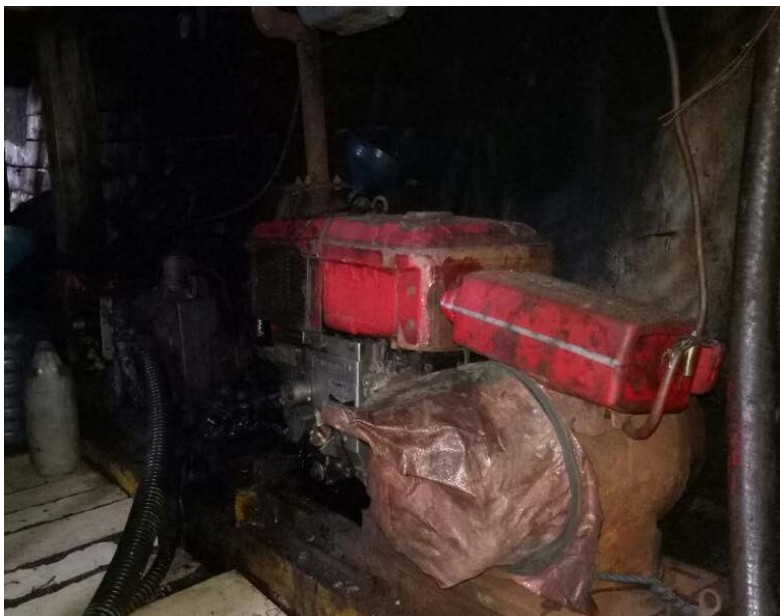
Gambar I-3 : Generator Fungka Permata III (Gambar diperoleh dari Kantor UPP Kelas I baubau)
