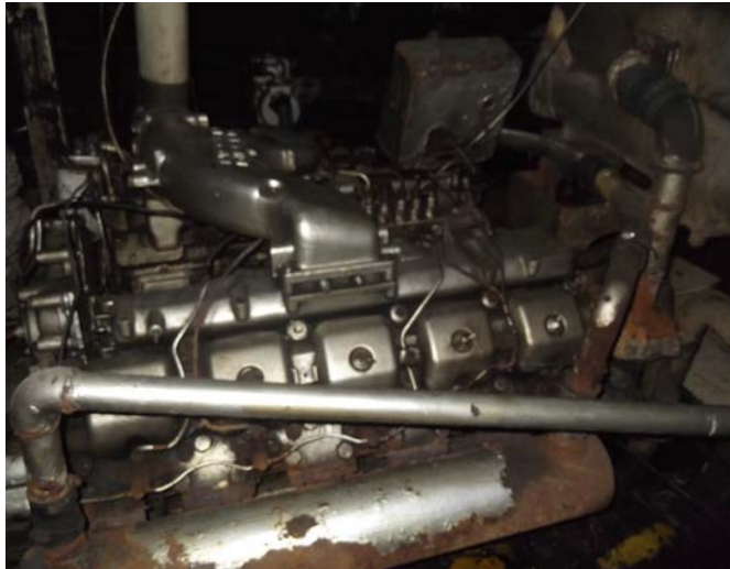
Gambar I-2 : Mesin penggerak utama Fungka Permata III (Gambar di peroleh dari kantor UPP Kelas I Baubau)
