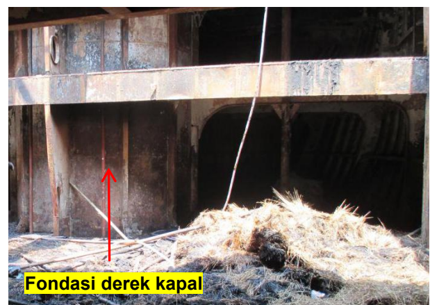
Gambar 9: Kondisi kerusakan kapal dan tumpukan sampah jerami di sisi kanan fondasi derek setelah kebakaran
