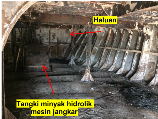
Gambar 6: Kerusakan di geladak tengah
