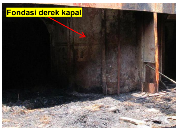
Gambar 8: Kondisi kerusakan kapal dan tumpukan sampah jerami di sisi kiri fondasi derek setelah kebakaran
