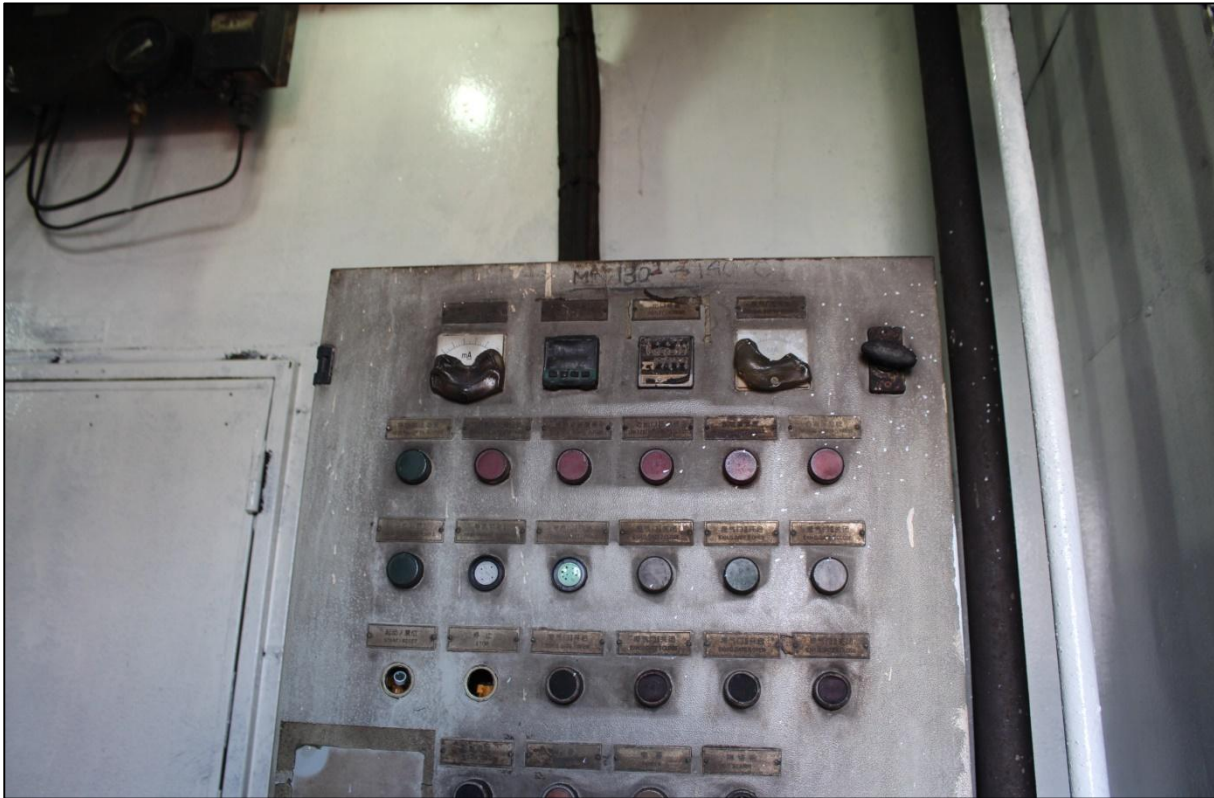
Gambar I-3: Panel exhaust gas thermal oil heater yang rusak akibat kebakaran.
