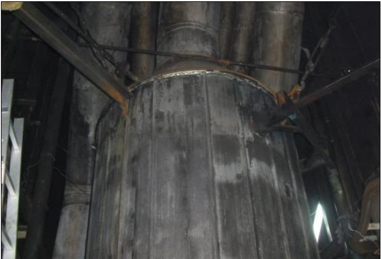
Gambar I-2: Exhaust gas thermal oil heater yang terbakar
