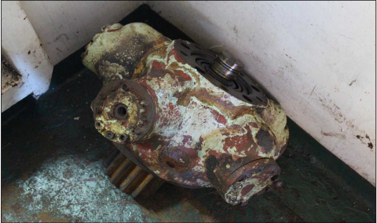
Gambar I-6: Rumah pompa hidrolis mesin jangkar yang pecah dan rusak
