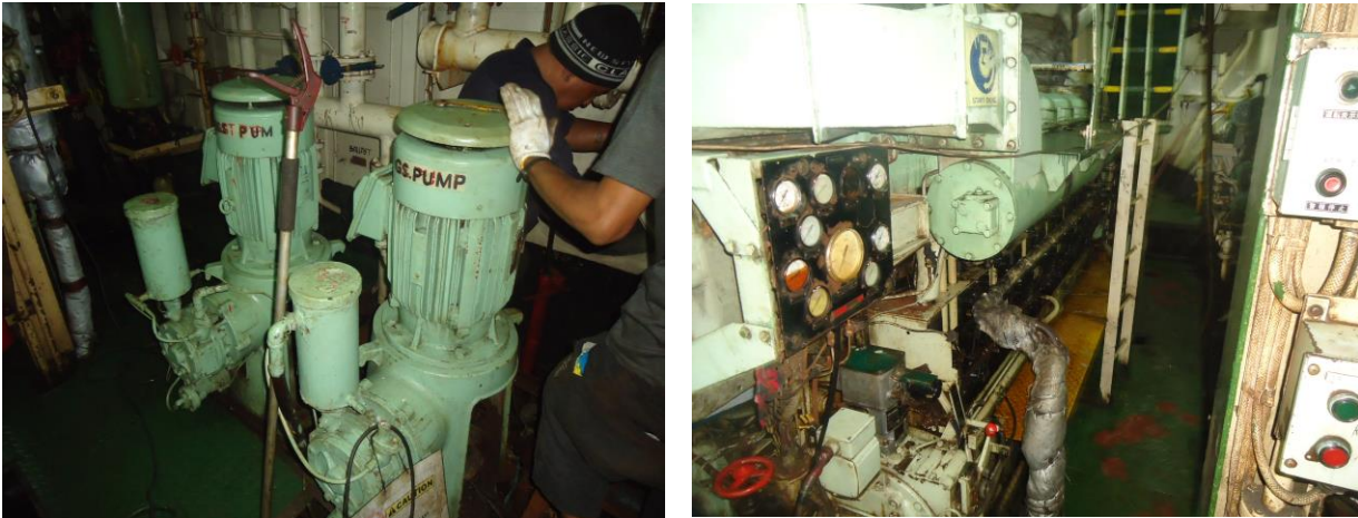
Gambar I-7: Mesin bantu dan pompa-pompa sebelum kebakaran
