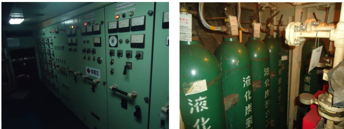
Gambar I-6: Ruang kontrol mesin dan ruang CO2 sebelum kebakaran
