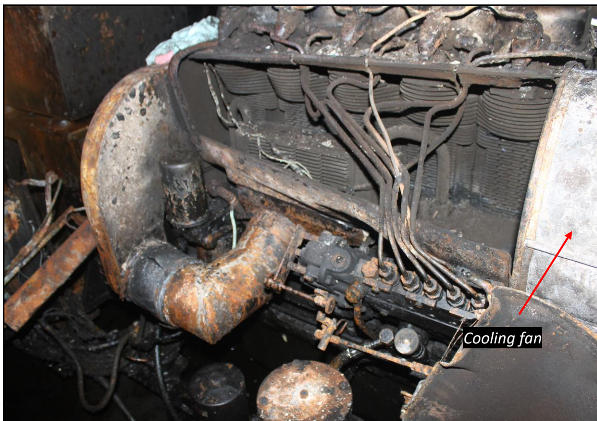
Gambar I-10: Generator Pelabuhan setelah kebakaran
