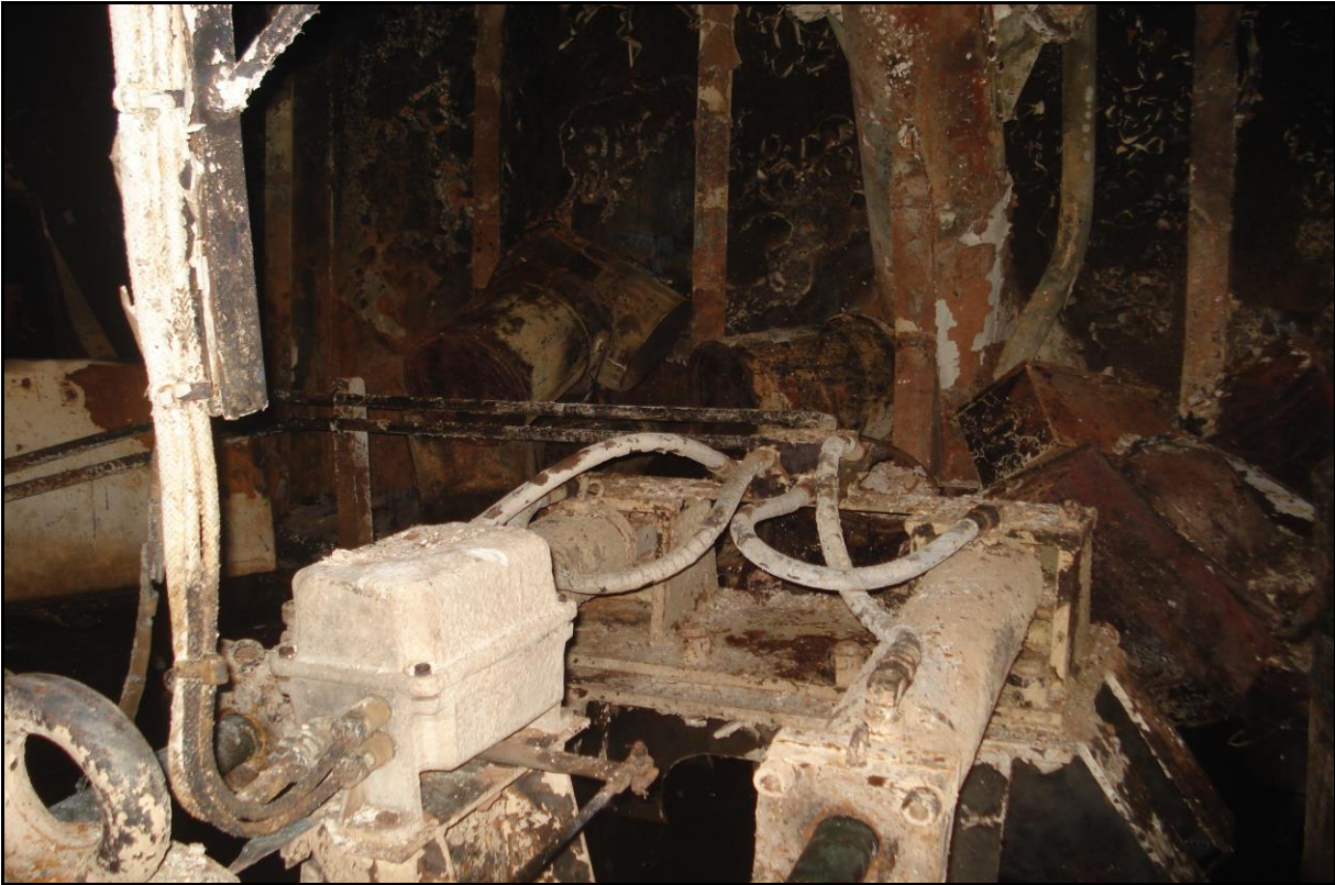
Gambar I-11: Kondisi mesin kemudi setelah kebakaran
