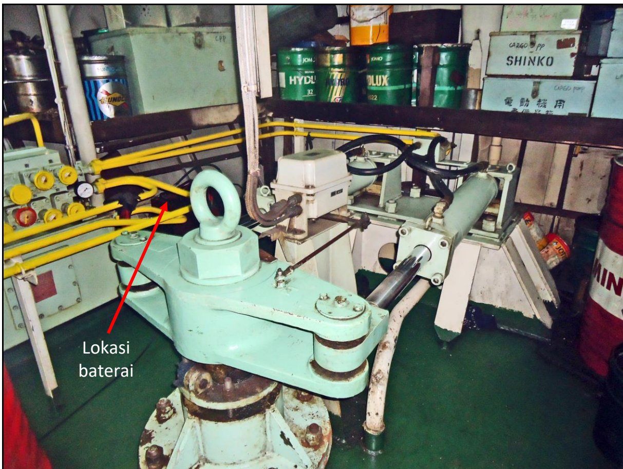
Gambar I-8: Ruang mesin kemudi sebelum kebakaran dan lokasi baterai
