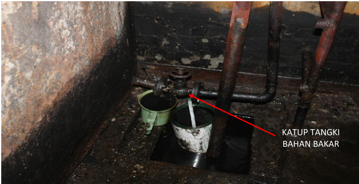
Gambar 5: Katup pada tangki bahan bakar
