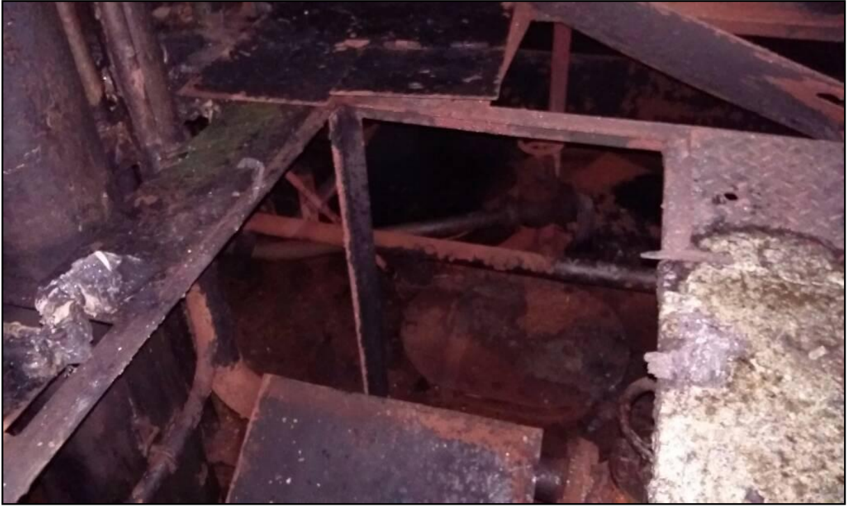
Gambar I-19: Lantai kamar mesin rusak dan terbakar
