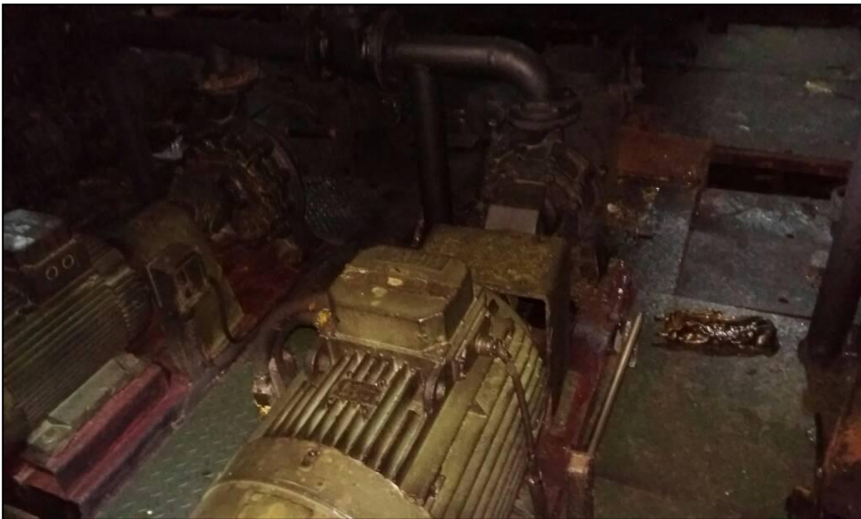
Gambar I-18: Kondisi pompa muatan dan pompa balas setelah ledakan dan kebakaran di kamar mesin
