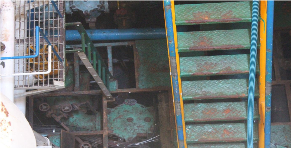
Gambar I-7: Kondisi ruang pompa Layar Samudera
