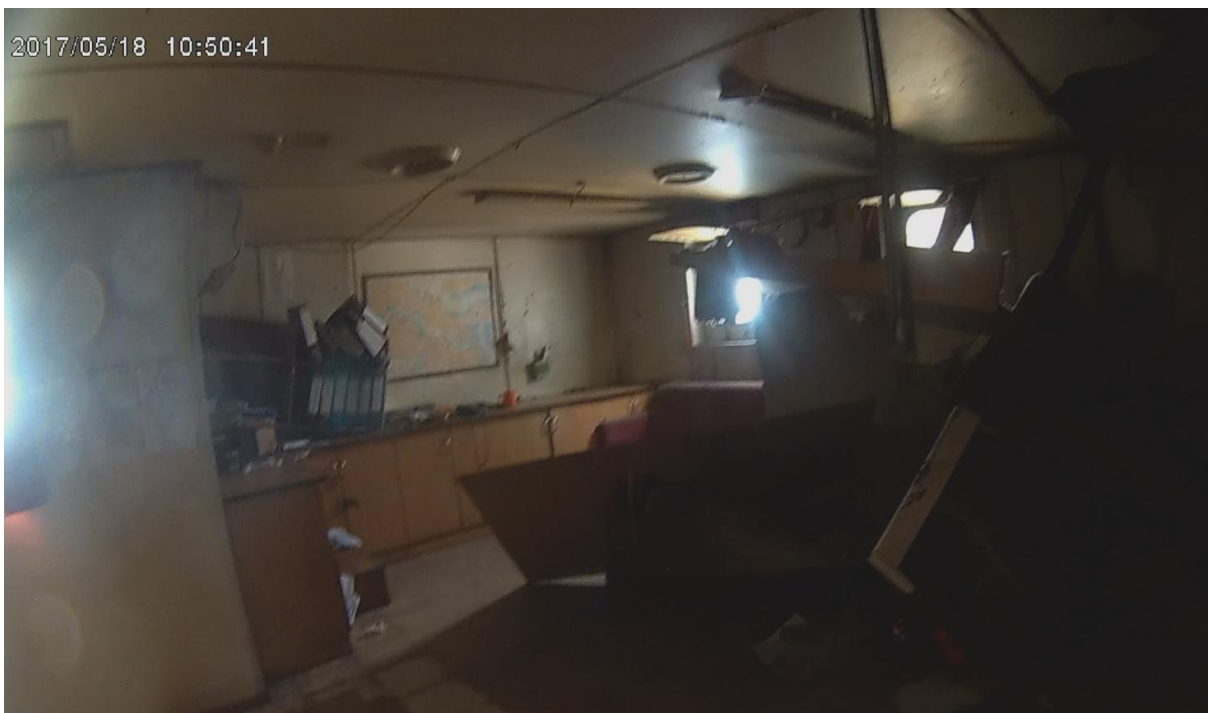
Gambar I-22: Akomodasi di atas kamar mesin sebelah kiri rusak parah
