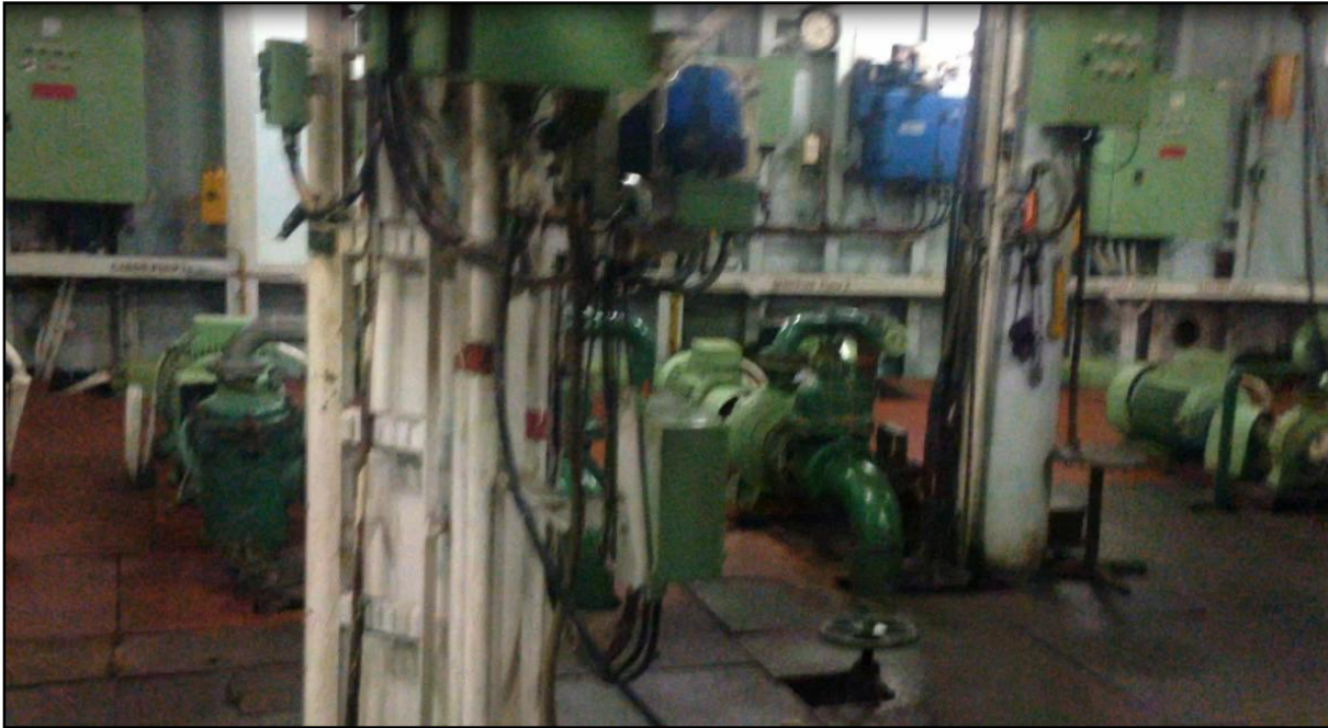
Gambar I-3: Kondisi kamar mesin sebelum terjadi ledakan (pada waktu docking)
