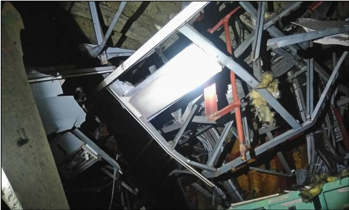
Gambar I-21: Kamar kontrol mesin plafon (ceiling) rusak berat
