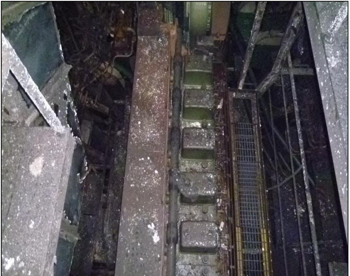
Gambar I-16: Kondisi mesin induk setelah ledakan di kamar mesin
