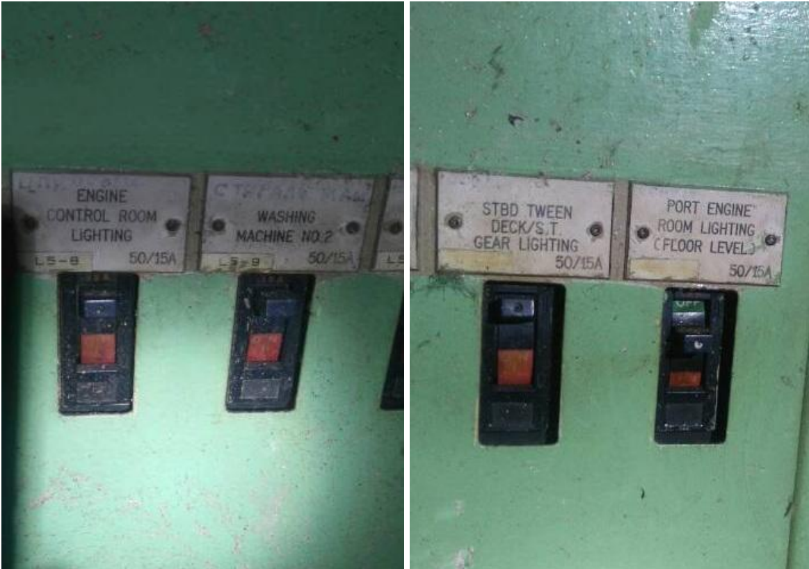
Gambar I-25: Panel Lampu kamar mesin yang beroperasi
