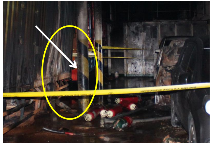
Gambar 6: Marking kebakaran pada tiang/pilar yang terbakar pada sisi truk (panah putih)
