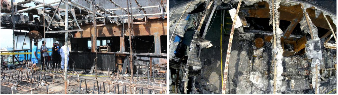
Gambar 3: Profil kerusakan geladak penumpang
