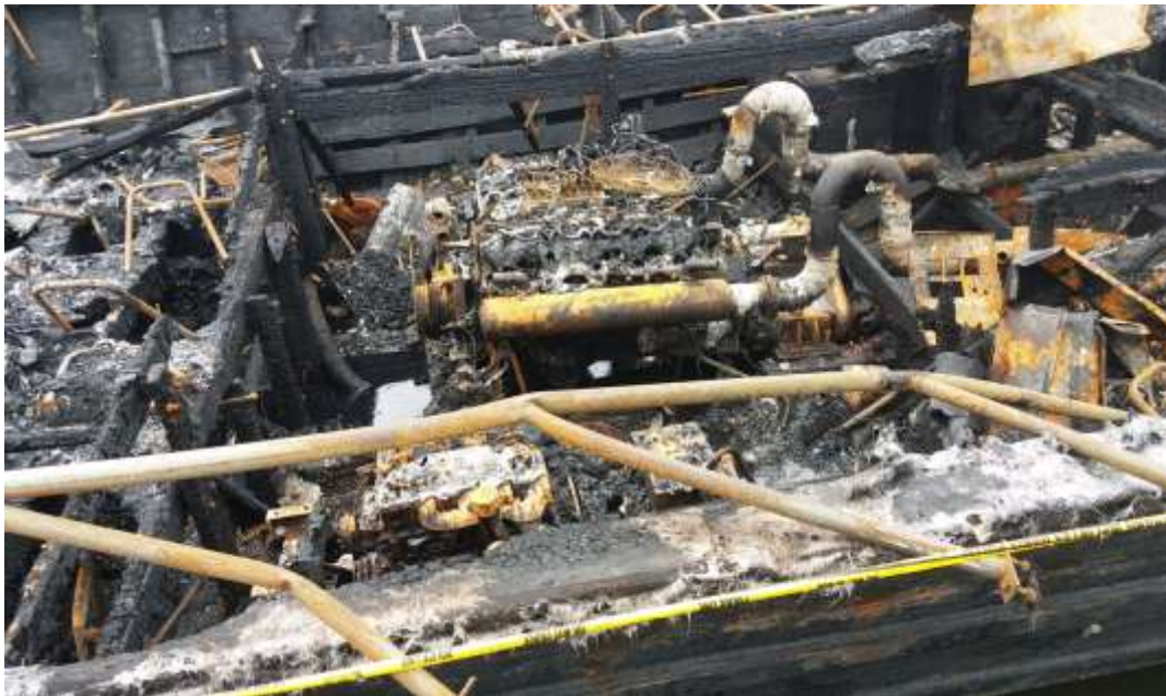
Gambar I-16: Kondisi kamar mesin KM. Zahro Express setelah terbakar
