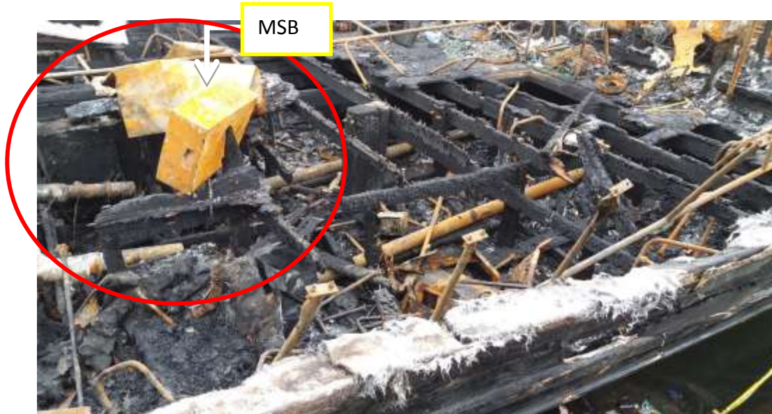
Gambar I-23: Kondisi papan hubung bagi utama (MSB) hangus terbakar
