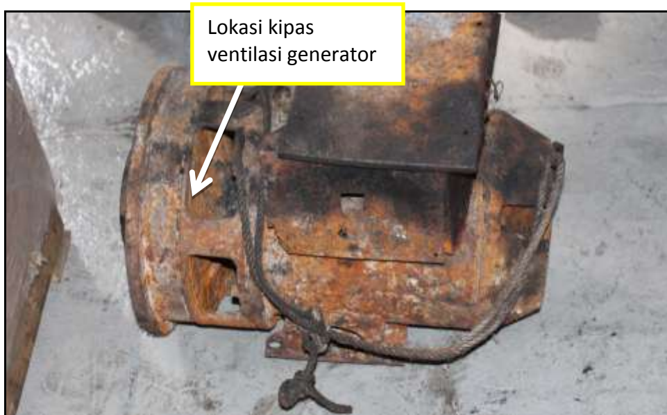
Gambar I-32: Kipas ventilasi generator KM. Zahro Express dilihat dari samping kiri
