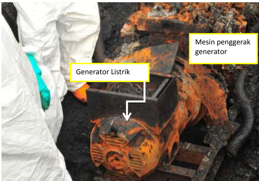
Gambar I-22: Kondisi mesin penggerak generator dan generator setelah kebakaran
