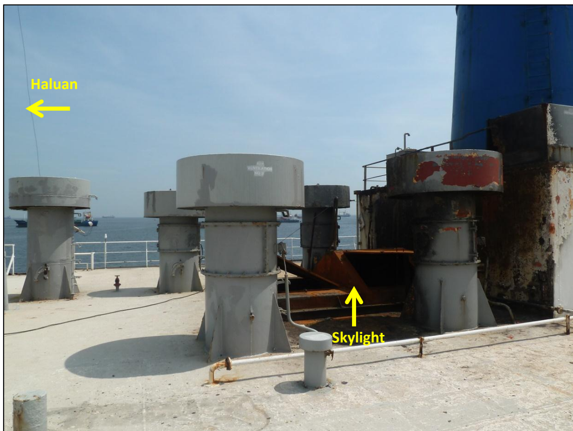
Gambar I-5: Skylight ruang mesin yang terbakar serta blower ruang mesin
