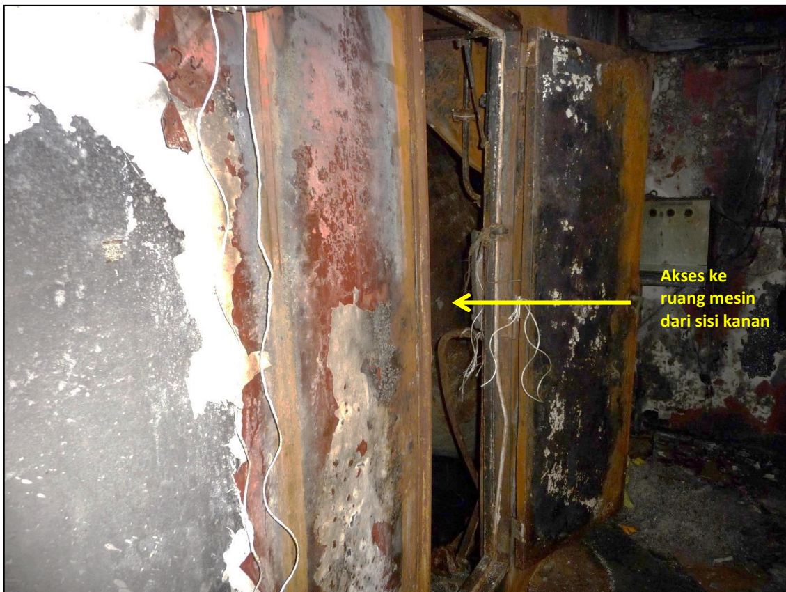
Gambar II-7: Kerusakan akibat kebakaran yang terjadi di ruang mesin yang menjalar hingga ke gang akomodasi sisi kanan melalui pintu akses ruang mesin sisi kanan
