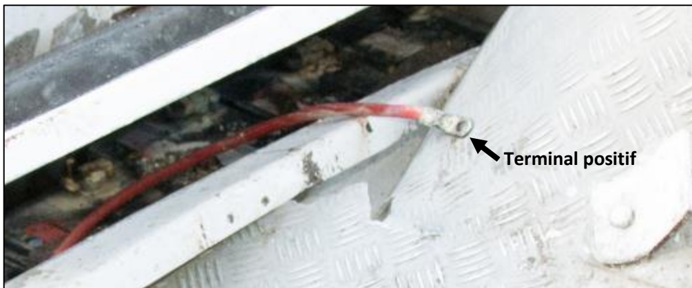
Gambar I-38: Kondisi salah satu kontak terminal positif aki.
