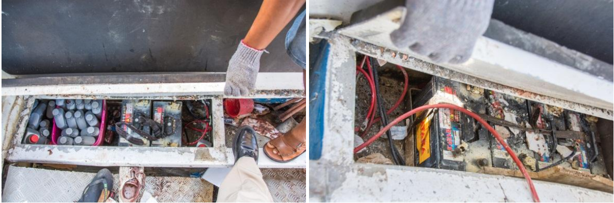
Gambar I-10: penempatan aki starter mesin pada ujung buritan ruang akomodasi. Gambar A tempat penyimpanan sisi kanan, gambar B tempat penyimpanan aki sisi kiri
