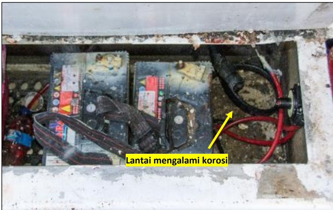
Gambar I-34: Kondisi ruang aki bagian kanan yang terisi dua buah battery.
