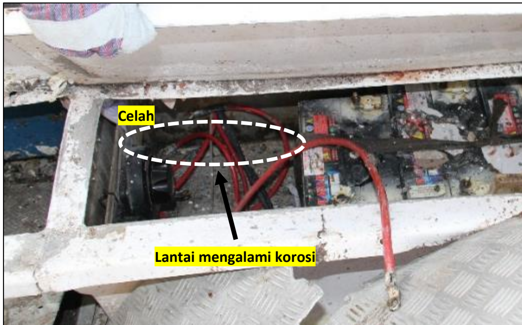
Gambar I-35: Kondisi ruang aki bagian kiri yang terisi empat buah battery.
