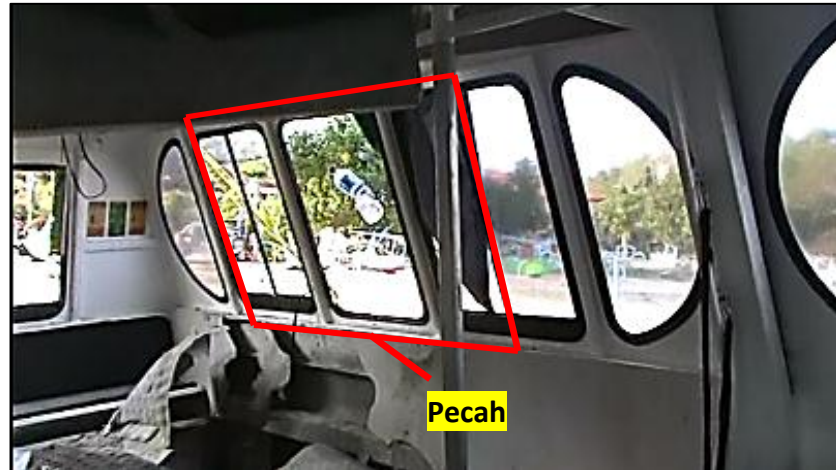
Gambar I-18: Kondisi kaca jendela bagian kiri-belakang.
