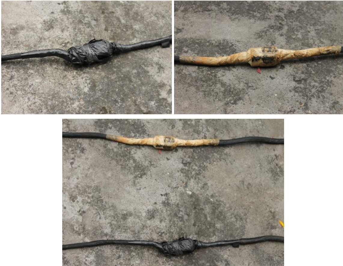
Gambar I-8: Contoh sambungan kabel listrik kendali mesin kapal
