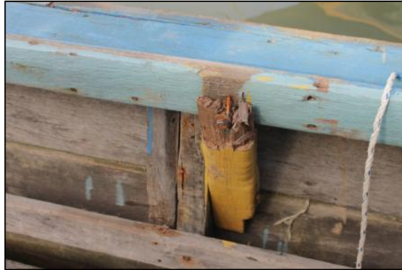
Gambar I-10: Tiang penyangga kanopi yang patah
