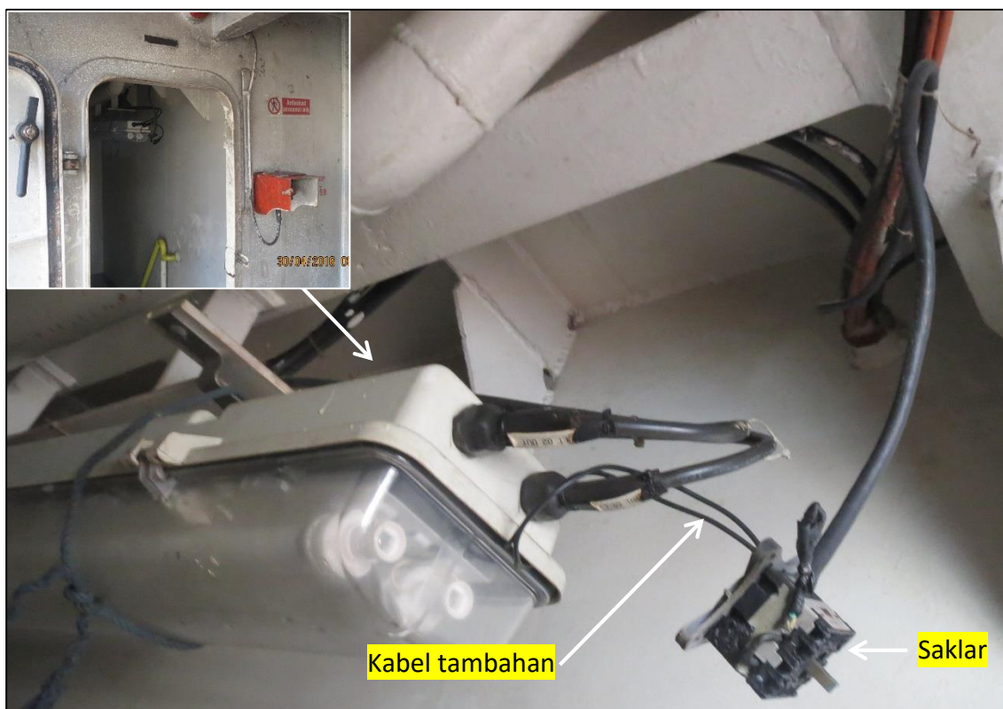
Gambar I-5: Modifikasi kabel pada lampu penerangan di pintu kanan ruang pompa (sumber: PT. PTK)
