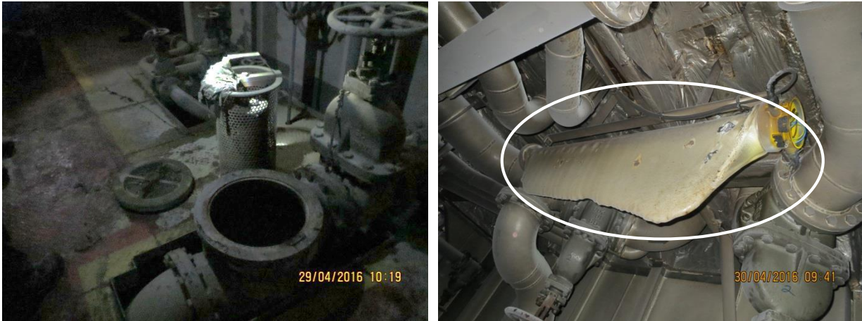
Gambar I-2: Kiri: saringan pompa kargo yang dibersihkan; Kanan: kondisi lampu penerangan di atas saringan pompa kargo (sumber: PT. PTK)
